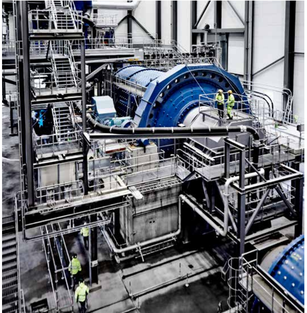
Kvarnhallen i Garpenbergs anrikningsverk.
